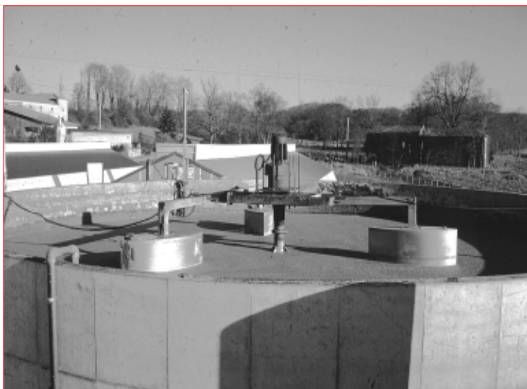
Photo 2. – L'élimination de l'azote par nitrification-dénitrification turbine lente (Technipompe) - (J. Coillard, Cemagref).
