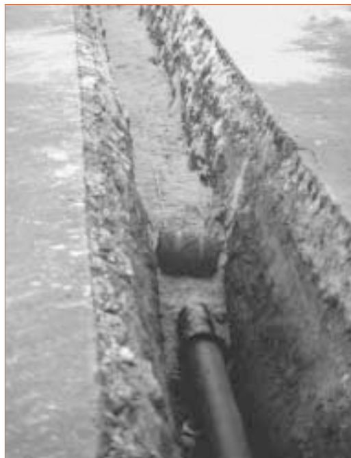
Photo 1. – La décision de renouvellement de conduite résulte d'une analyse des défaillances et d'une analyse économique des choix possibles. ►
