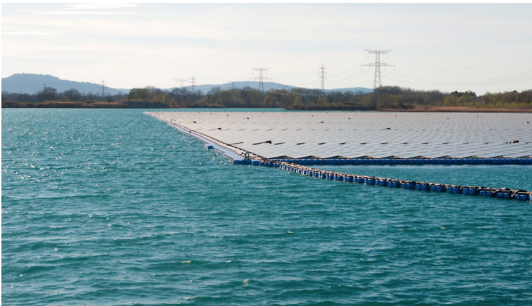
Photo ① – Installation photovoltaïque flottante dans la vallée de la Durance (photo : Héctor Rodríguez Pérez).
