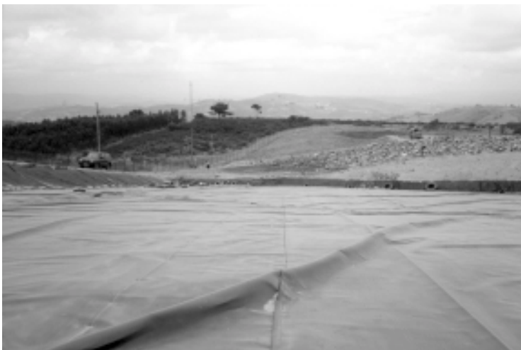
▲ Photo 2. – Exemple de plis des géomembranes PEHD lors de la mise en oeuvre (photo Y. Matichard).
