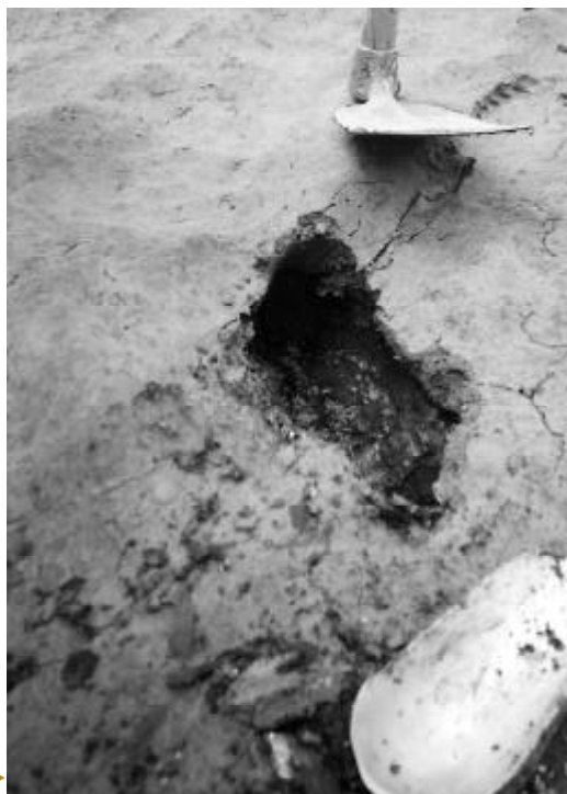
Photo 3. – Trou de racine pourrie, découvert en surface du parement aval, sous le contact avec le géotextile (photo P. Royet).
