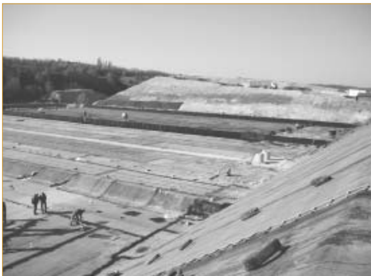
▲ Photo 1 – Installation classée (centre de stockage de déchets, photo APAVE).
