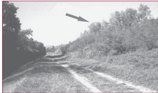
◀ Figure 15 – Repousses sur talus aval.
