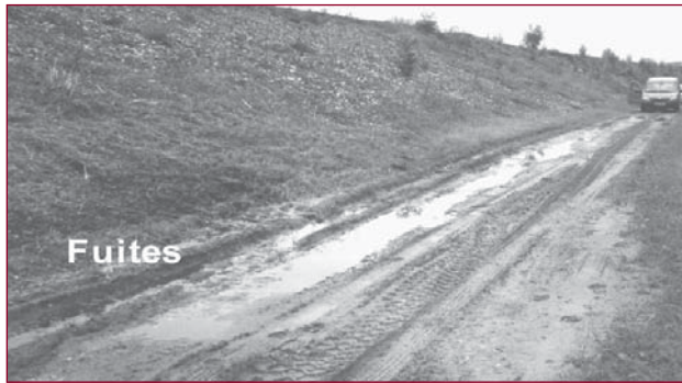
▲ Figure 4 – Fuites sur risberme.
