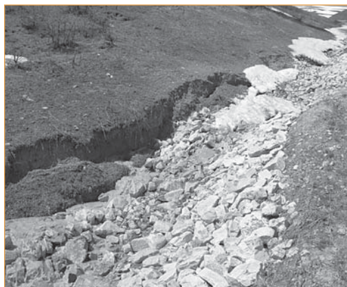
◀ Photo 3 – Vue d'un drain principal incisé à la fonte des neiges.
