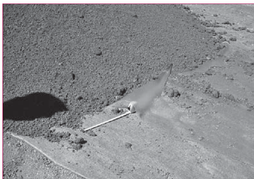
▲ Figure 5 – Planches d'essai : apparition d'un pli au pied de la planche d'essai.
