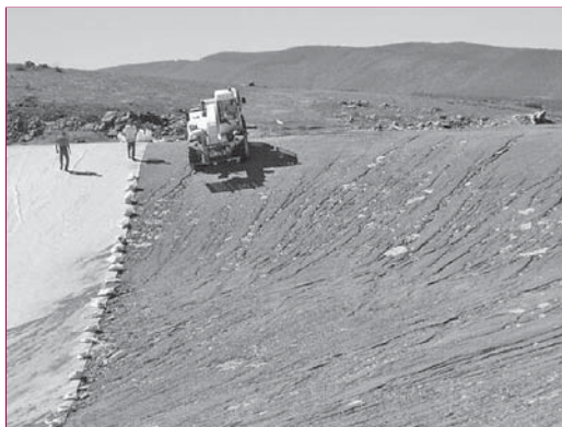
▲ Figure 8 – Ravinement et dégradation du support et du géotextile après l'orage.
