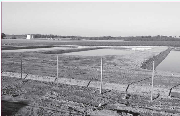
▲ Figure 2 – Vue des bassins à l'issue de la mise en eau suivant la réalisation.
