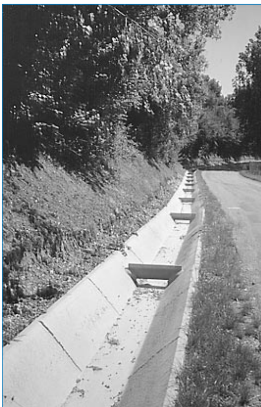
▲ Photo 3 – Fossé de bord de route avec limiteurs de débit.
