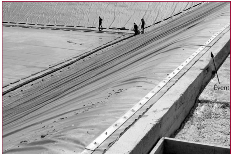
▲ Figure 7 – Bassins de Cargèse. Détail de l'ancrage en tête sur longrine béton, et évent dans l'ancrage. En pied de talus, on voit les lignes de flotteurs et la ligne de lest qui forment le dispositif de mise en tension.
