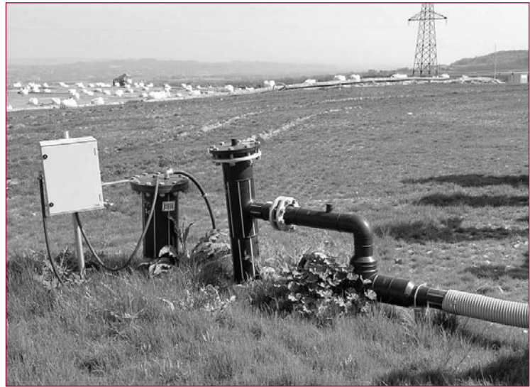
▲ Photo 1 – Dispositif de captage du biogaz sur une installation de stockage de déchets (source : J.-P. Gourc).
