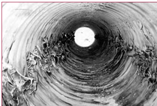
► Figure 13 – Rupture de géodrain.
