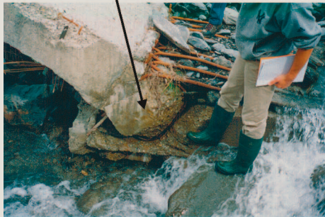
Rupture totale (encastrement voile-semelle)
