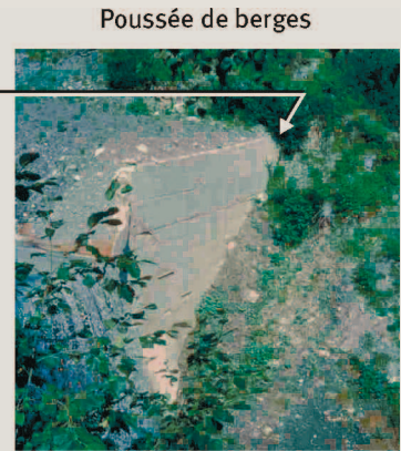
Glissement rive gauche
