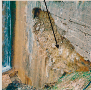
Dégradation du béton
