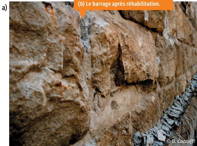
3 (a) État de surface du barrage de Kadamparai avant réhabilitation. (b) Le barrage après réhabilitation.
