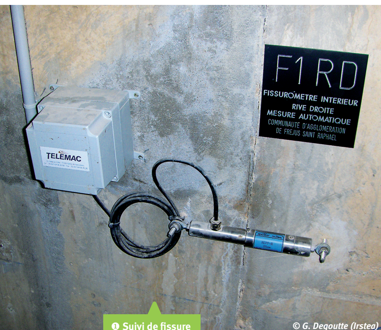
1 Suivi de fissure par fissuromètre.
