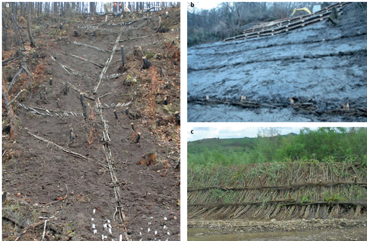
Figure 6 – Ouvrages avec fascines en talus (a) Fascine drainante, (b) Fascine de pente et (c) Matelas en fascines. Photo a : © Terra Erosion Control ; photo b : © Pierre-André Frossard ; photo c : © André Evette.
